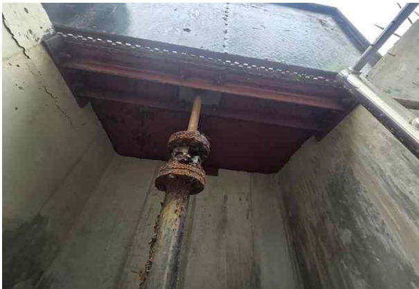
손상내용 제수밸브실 상부덮개 손상원인 상태양호
