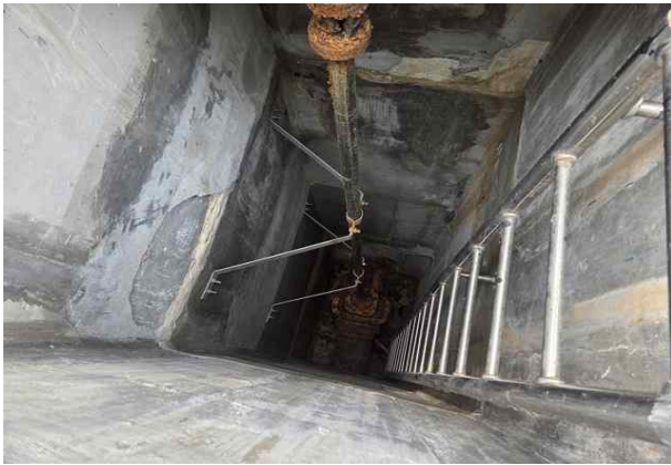
손상내용 제수밸브실 배관부식 손상원인 외부 우수유입, 습윤침투
