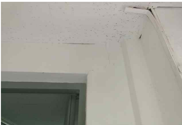
손상내용 관리실 내부 벽체 균열 손상원인 건조수축, 온도변화
