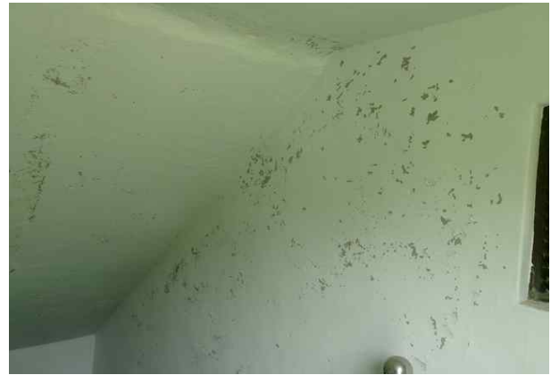
손상내용 검수실 내부 벽체 도장박리 손상원인 시공미흡, 장기공용
