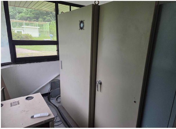
손상내용 현장제어반 상태양호 손상원인 -
