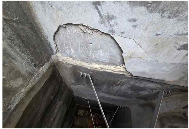
손상내용 제수밸브실 벽체 박락 손상원인 장기공용, 시공미흡
