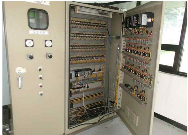
손상내용 현장제어반 상태양호 손상원인 -
