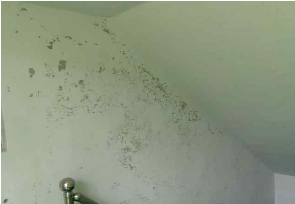
손상내용 검수실 내부 벽체 도장박리 손상원인 시공미흡, 장기공용
