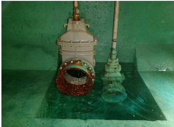
손상내용 1지 유출배관 부식 손상원인 공용열화
