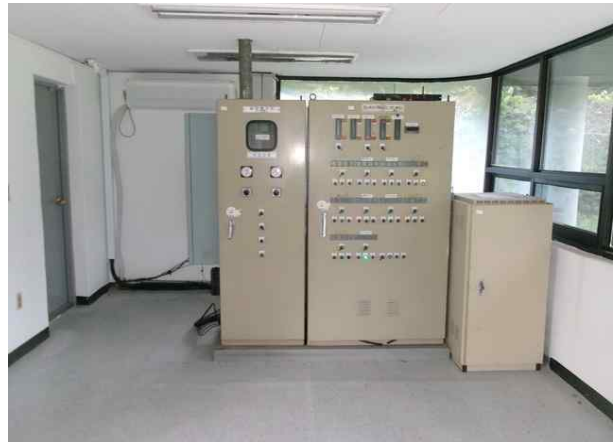
손상내용 현장제어반 상태양호 손상원인 -
