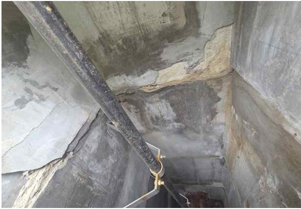
손상내용 제수밸브실 벽체 박락 손상원인 장기공용, 시공미흡
