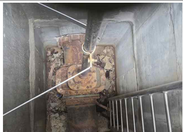
손상내용 제수밸브실 배관부식 손상원인 공용열화
