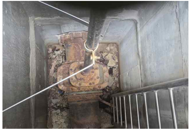
손상내용 제수밸브실 배관부식 손상원인 외부 우수유입, 습윤침투
