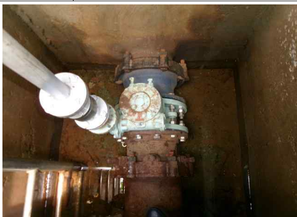
손상내용 유입밸브실(1지) 배관부식 손상원인 공용열화
